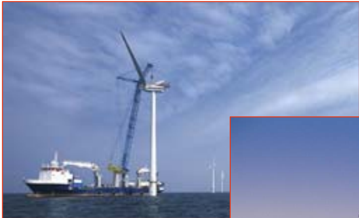
Parc éolien offshore Horns Rev (Danemark)
