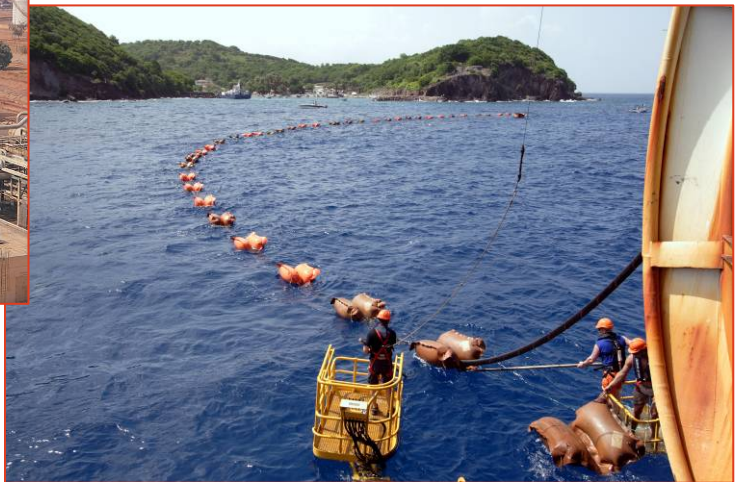
Câble HT sous-marin Hainan (Chine)
